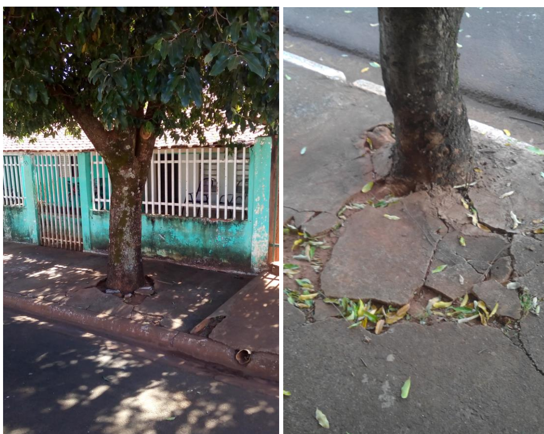
Figura 1: Corte de calçada inferior ao necessário para o crescimento da árvore.
